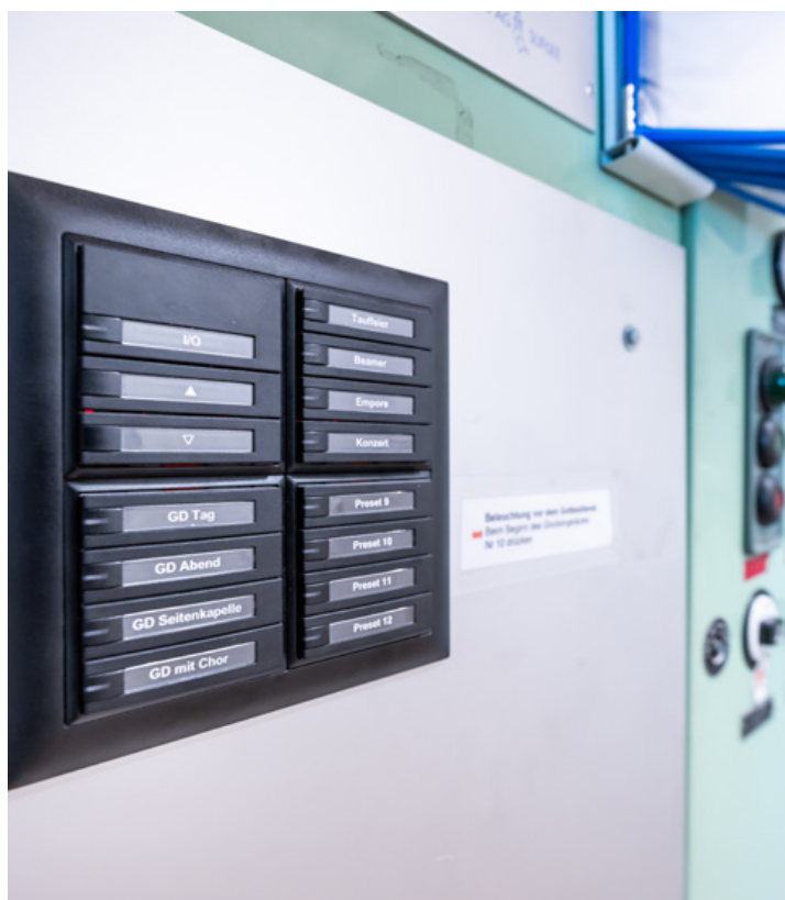
Le tableau de commande qui permet de moduler l'éclairage.
