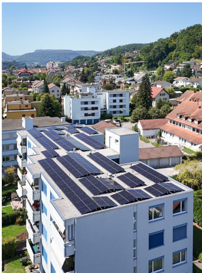
Vue aérienne de l'installation. La géométrie particulière du toit a exigé une planification spécifique de la disposition des panneaux.
