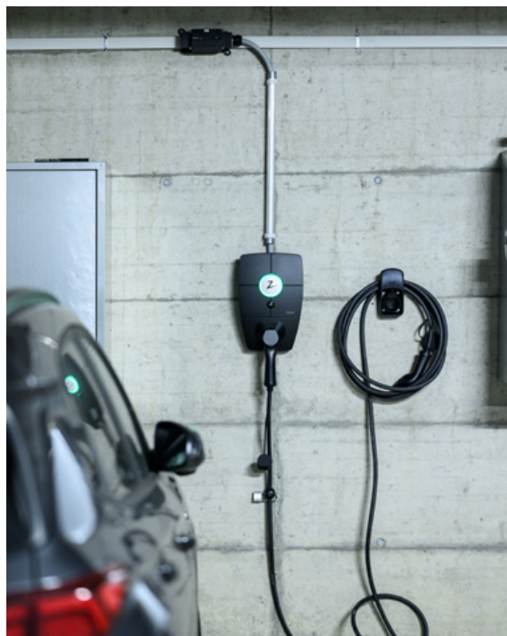
Une installation de recharge complète : en haut, le câble de base auquel est raccordé un boîtier mural (wallbox).
