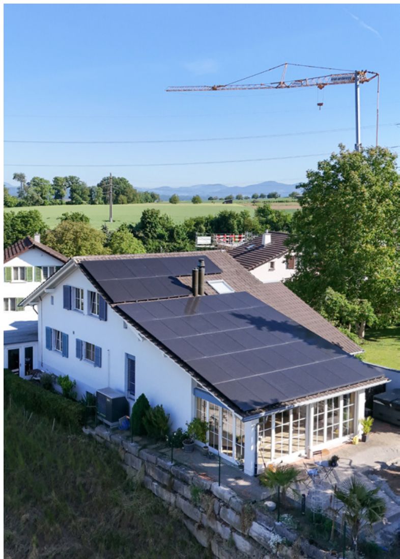
Von aussen eine gewöhnliche Solaranlage, im Innern sorgt der Energy Manager dafür, dass der erzeugte Strom optimal vor Ort genutzt wird.
