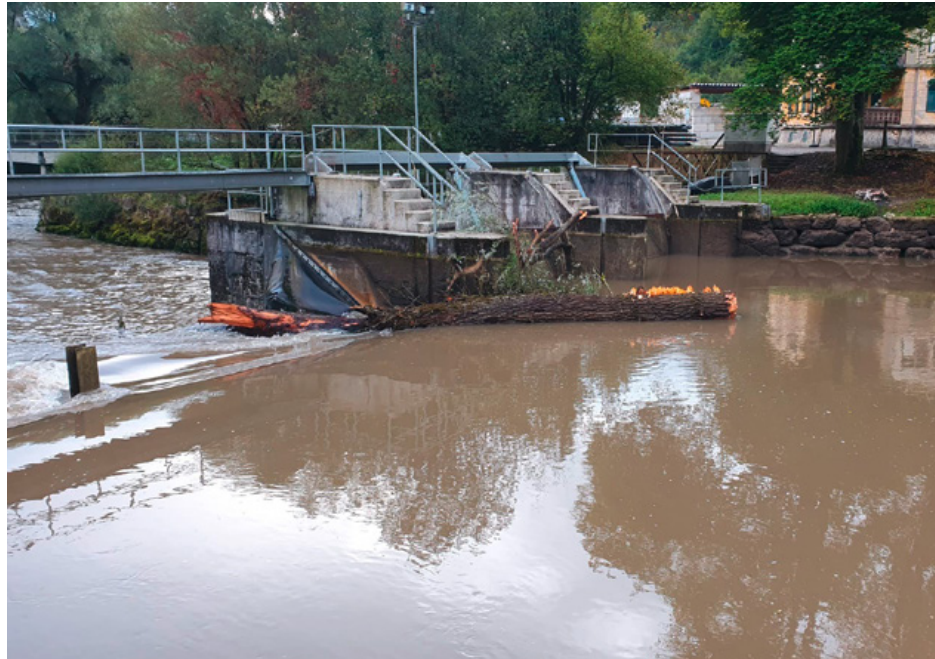
Der Schlauchwehrschaden mit seiner wahrscheinlichen Ursache.
