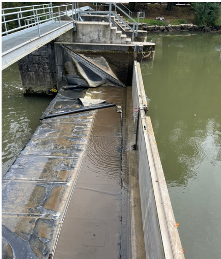
Die provisorischen Dammbalken stauen das Wasser etwas weniger hoch als das Schlauchwehr.
