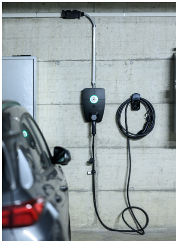
Eine komplette Ladeinstallation: Oben das Basiskabel, an dem eine Wallbox angeschlossen ist
