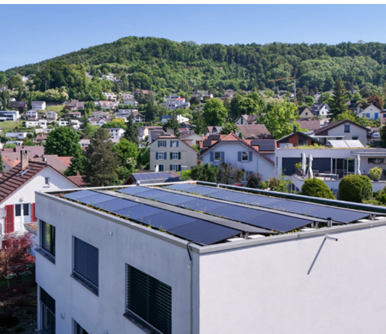
Avec cette installation de 72 mètres carrés, le propriétaire couvre environ 80 pour cent de ses besoins en électricité.
