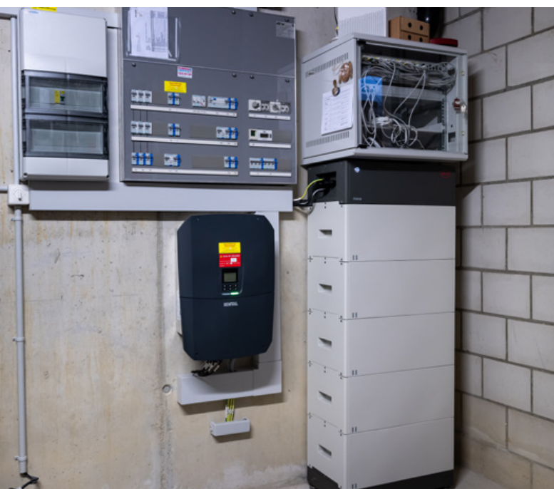
Der Speicher übernimmt, wenn die Sonne nicht scheint oder gleich das ganze Netz ausfällt.
