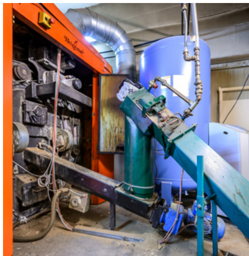
Le système actuel de chauffage aux copeaux de bois arrive en fin de vie.
