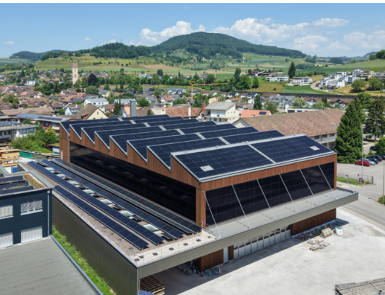
Les installations solaires situées sur l'auvent de l'entrée et sur la façade appartiennent à ADEV.
