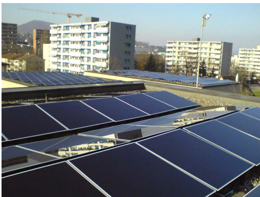
PV-Anlage Fraumatt Liestal
