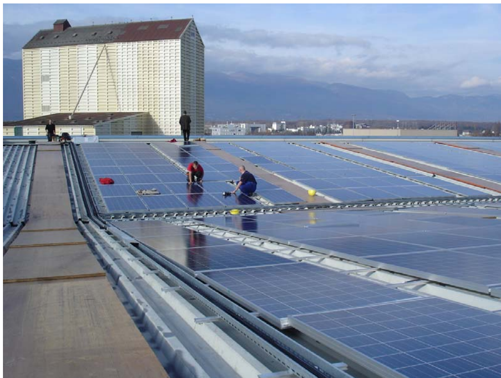
PV-Anlage Feldschlösschen Satigny
